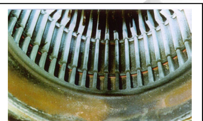
Combustible avec CCF POWER SHILED HP, Bruleur WISSMANN, sans cendres ni dépôts.
