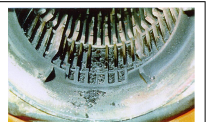
Combustible non traité, dépôt de cendre
